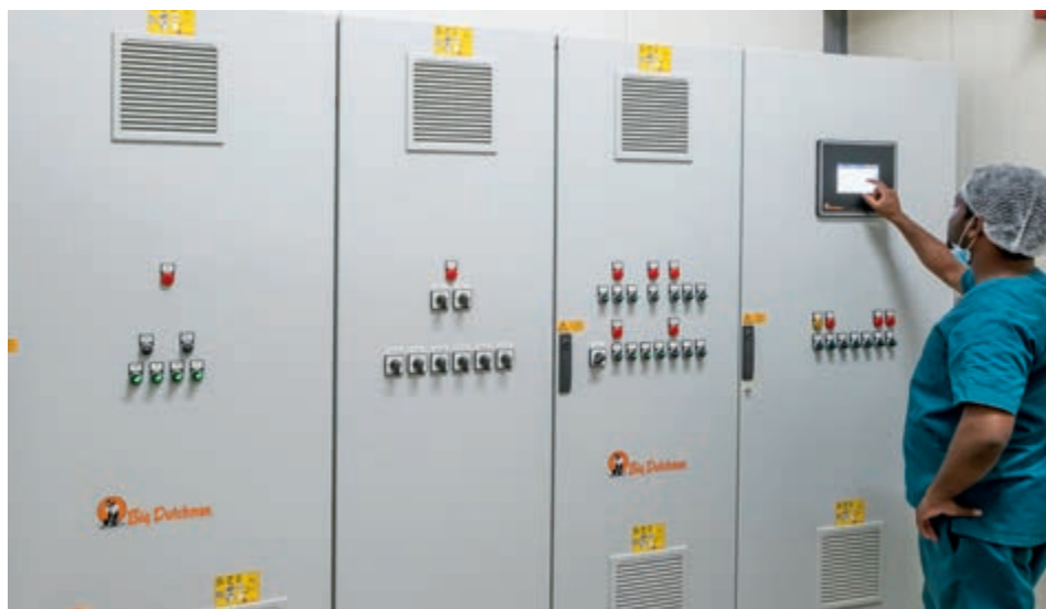
Современный шкаф управления: наглядность конструкции, доступность обслуживания, высокая степень защиты, привлекательный дизайн
