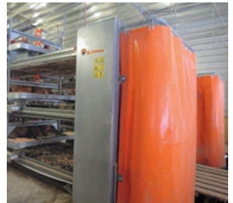
Пластиковая шторка перед пометным колодцем
