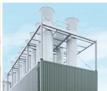
Системы вентиляции, отопления, охлаждения
