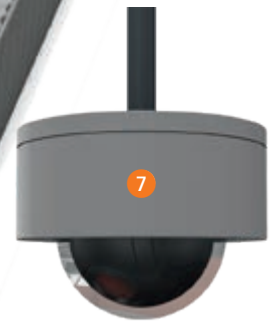
Cámara de la nave
