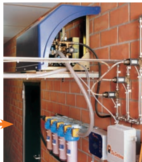
Центральна помпа із чотирьохступневим фільтром
