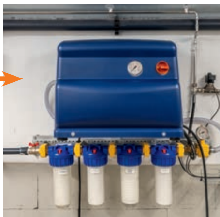
Центральная насосная установка с 4-ступенчатым фильтром
