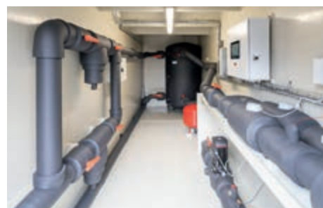
Система управления и накопительная емкость для холодной воды
