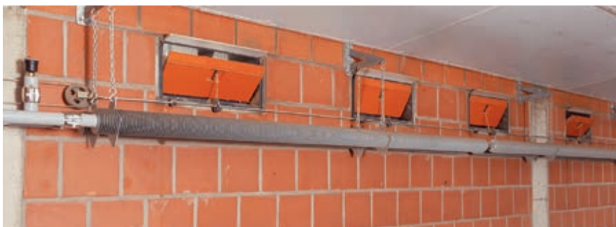
Отапливание помещений с помощью ребристой трубы из алюминия – идеально в сочетании с приточными клапанами CL 1200
