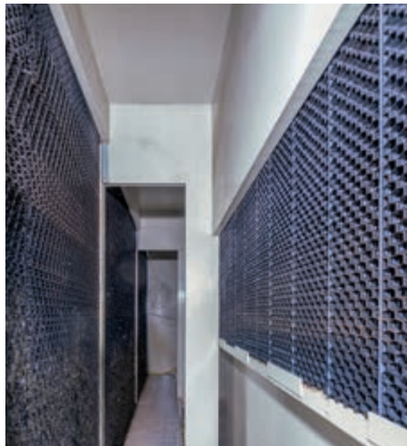
A sinistra: batteria di filtri; a destra: separatore di gocce
