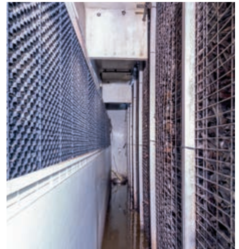
A sinistra: separatore di gocce; a destra: batteria di filtri biologici con sterpi come materiale di riempimento
