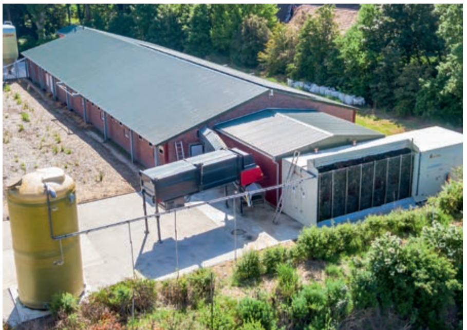
Capannone Xaletto® con lo scrubber PURO-X
