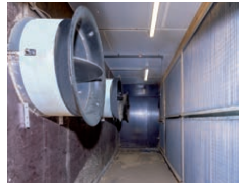
Corridoio di pressione con filtro polveri StuffNix a monte
