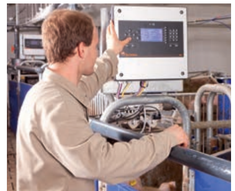
Stazione di controllo computerizzata
