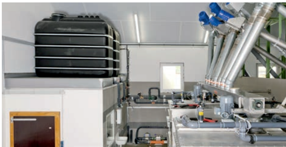
Local soupe avec 2 cuves d'alimentation sans résidus et 2 cuves d'eau fraîche de 2 000 litres
