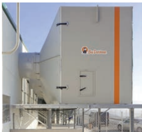
Montage en ventilation centralisée
