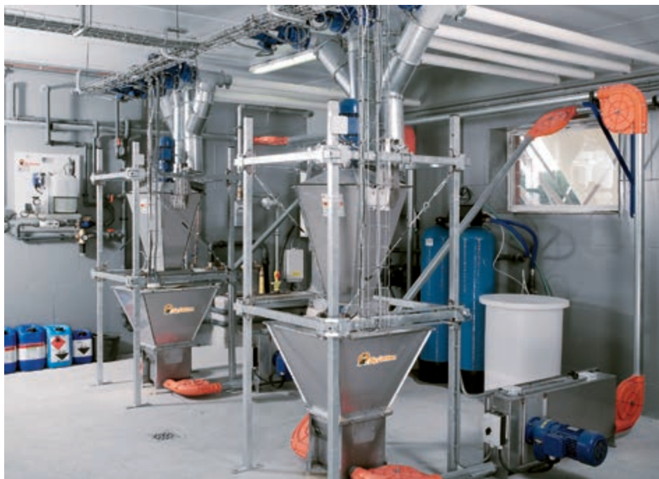
Salle de préparation DryExact pro : deux installations avec chacune un circuit
