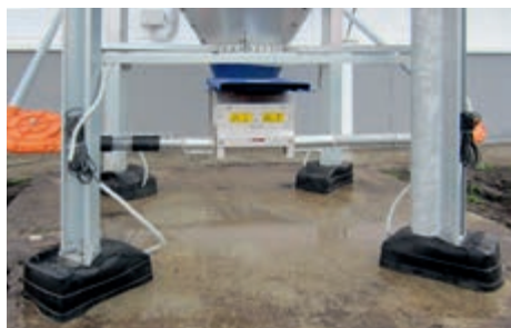
Pieds de silo protégés en prévision de conditions climatiques extrêmes
