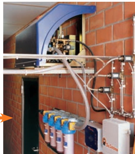
Equipo central de bomba con filtrado de 4 pasos
