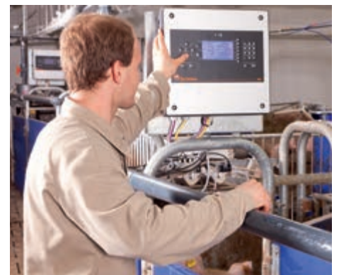
Ordenador de la estación
