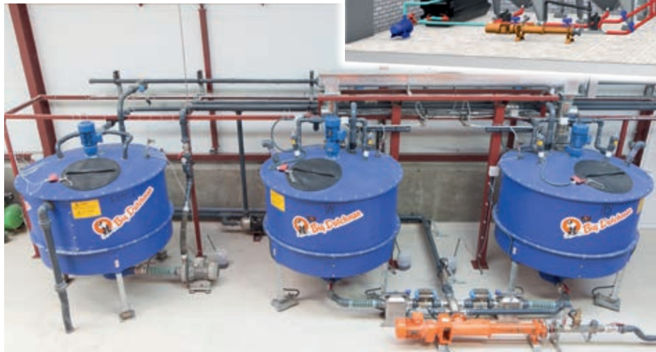
Sistema de 2 tanques con tanque de agua usada
