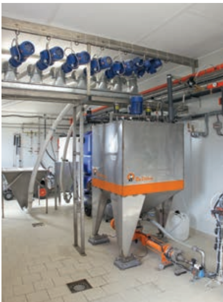
Sistema de 1 tanque sin restos con aire comprimido
