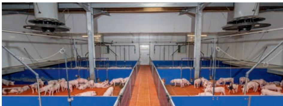
Uso de chimenea F.A.C. 2 en una nave de destete
