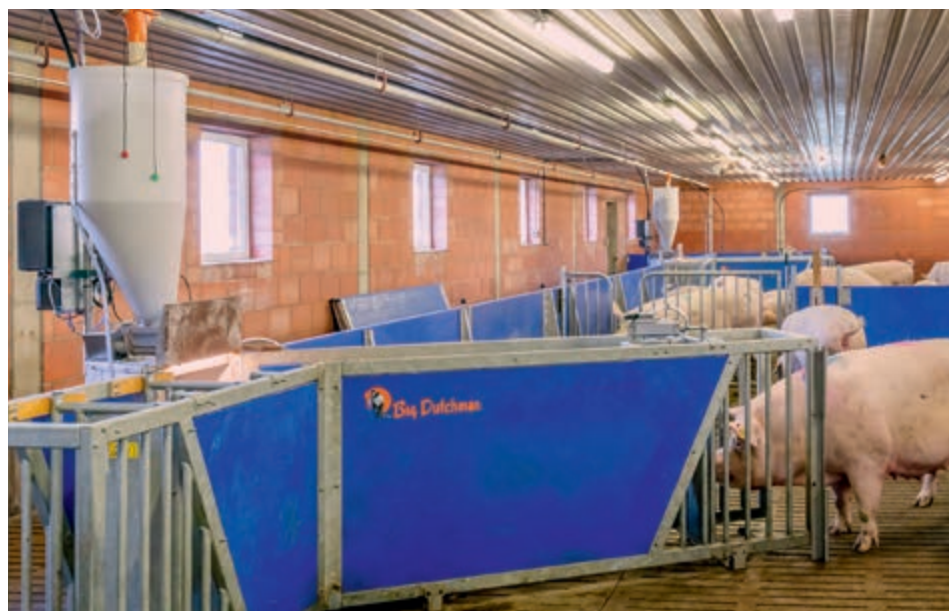
Uso del techo DiffAir en una nave de gestación para cerdas
