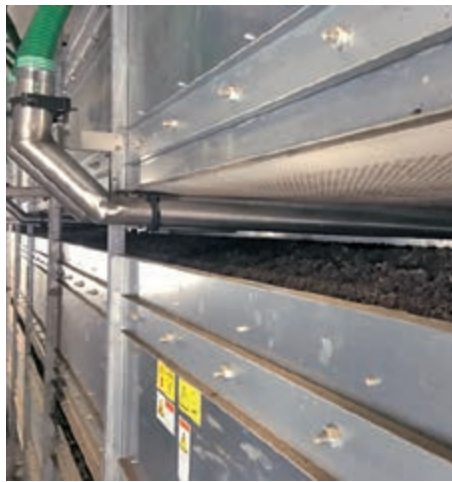
Con sistema de distribución se repartirá uniformemente la fase líquida sobre el material a secar
