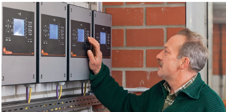
Alle sorteringsvægte TriSort pro bliver styret vha. en Controller, som her er installeret i et for-rum (tilstødende rum)
