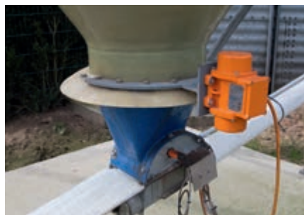
Silo med elektrisk vibrator
