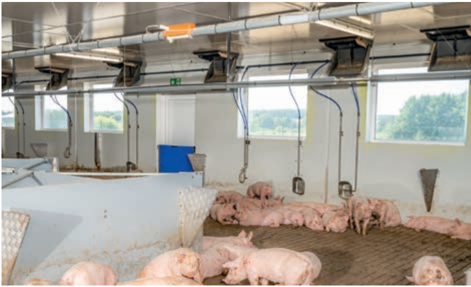
CL 1540 – im Sommer mit weit geöffneter Ventilklappe
