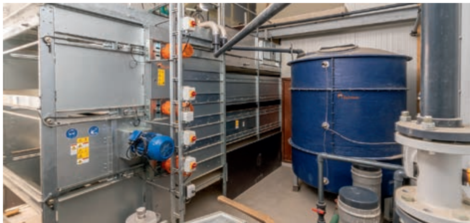
Lagerung der flüssigen Phase in einem Vorratstank
