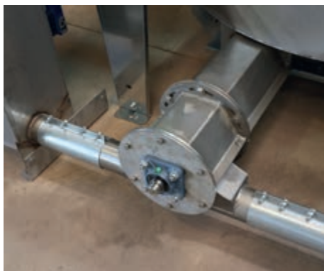
Spezielle Übergabeeinheit von der Austragschnecke des Dosierers auf die Rohrkettentransportation DR 1500
