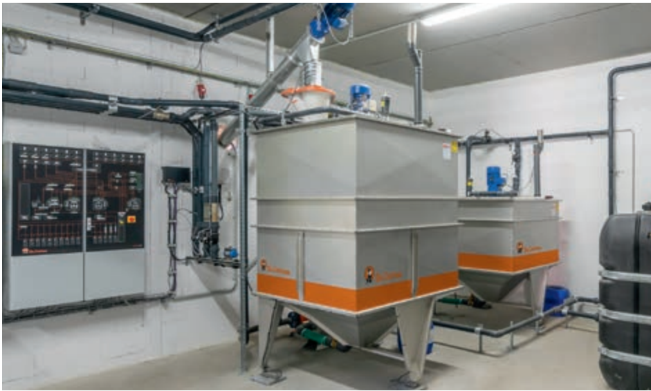
1-Tank-Anlage mit gewogenem Brauchwassertank
