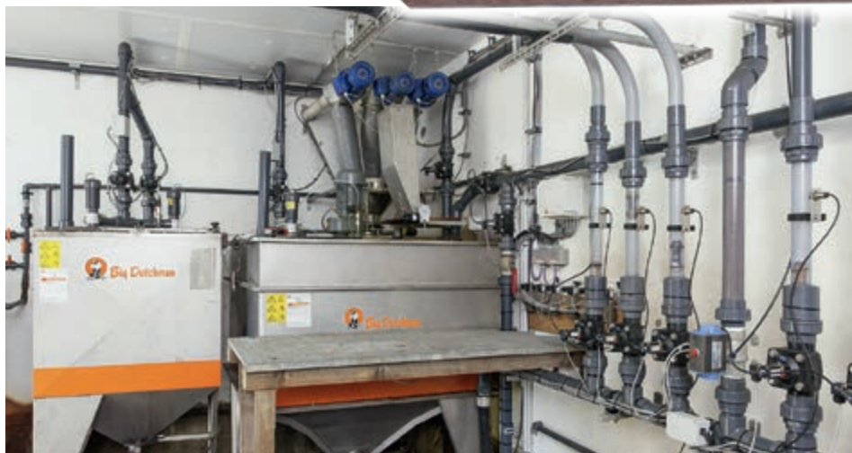
1-Tank-Anlage mit Brauchwassertank und vier JET-Stichen
