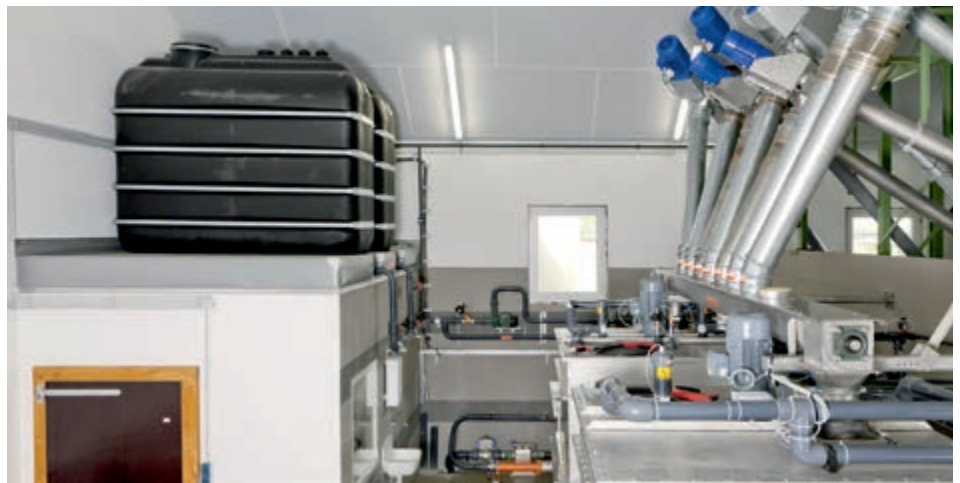
Futterküche mit einer 2-Tank-Restlosfütterung und zwei 2000 l-Frischwassertanks
