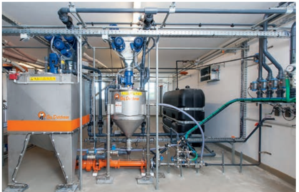
2-Tank-Anlage mit einem kleinen und einem großen Tank
