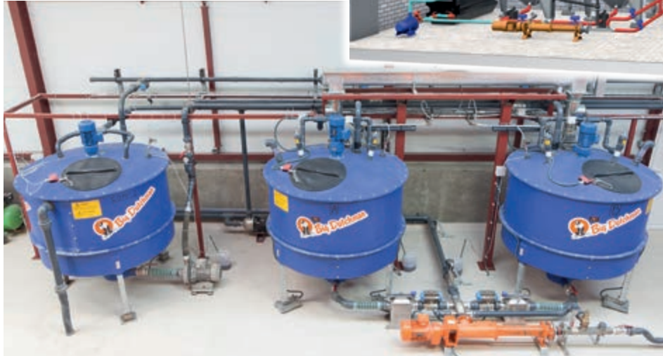
2-Tank-Anlage mit Brauchwassertank
