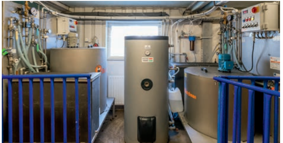
CulinaCup-Futterküche mit zwei Anmisch tanks
