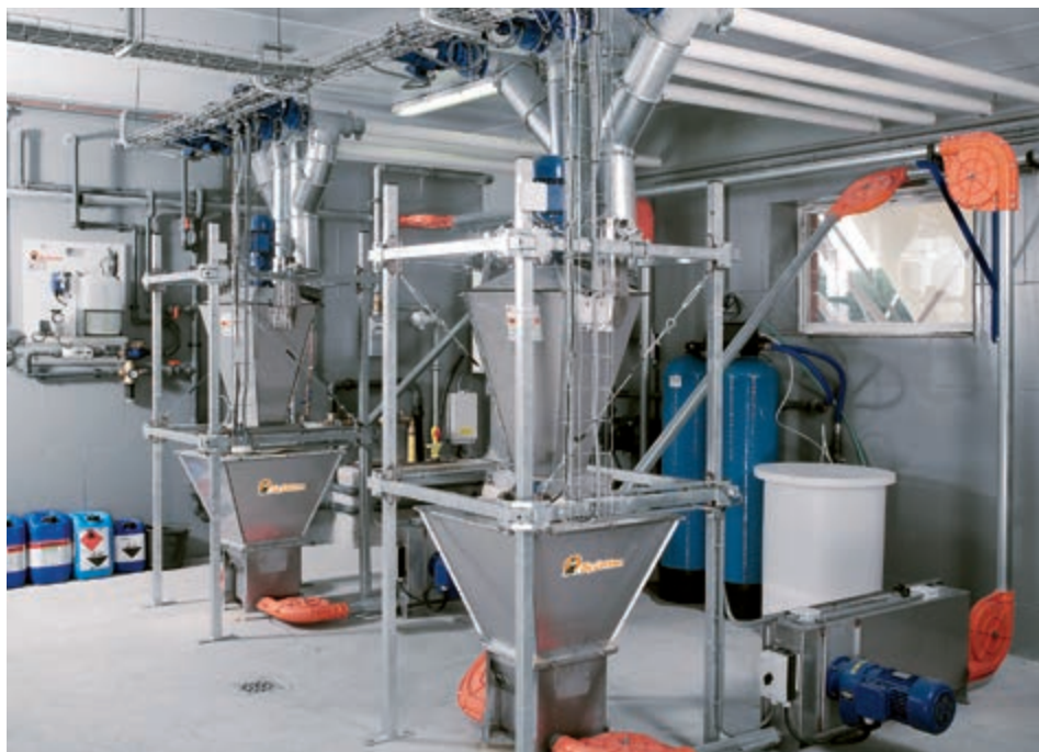
DryExactpro - фуражна кухня: две инсталации всяка с 1 кръг
