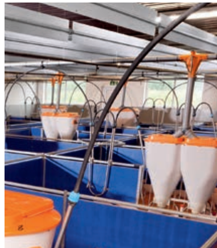
Сдвоена тръба защитена от запрашаване
