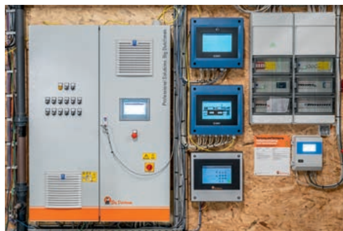
Commande de la climatisation et de l'alimentation – tout fonctionne de manière entièrement automatique
