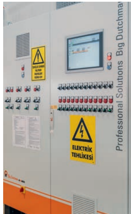
Armoire de commande avec écran tactile de 15" pour piloter le ramassage des œufs jusqu'à l'emballeuse
