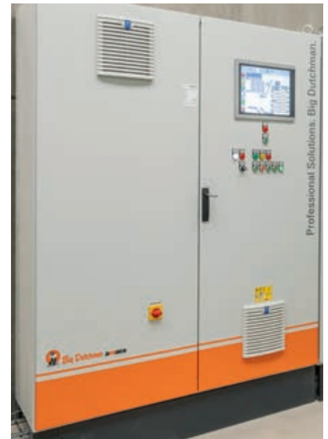
Armoire de commande du sécheur à plaques OptiPlate
