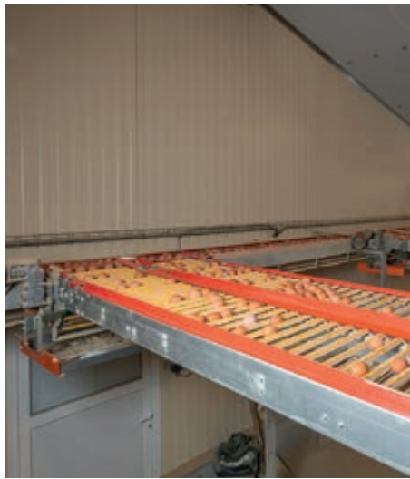
Transfert de la bande longitudinale vers le convoyeur transversal
