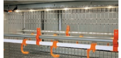
FlexLED para la iluminación del segundo piso
