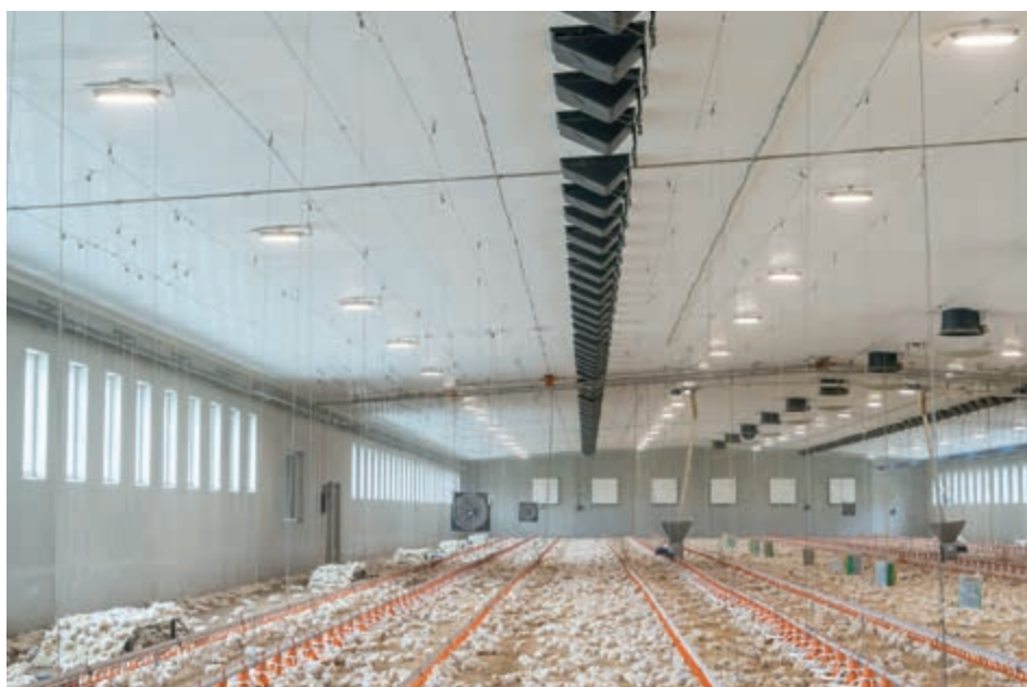
Zastosowanie wlotu sufitowego CL 1540 w kurniku dla brojlerów
