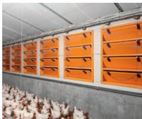
MultiVent 4 w kurniku dla stada reprodukcyjnego brojlerów
