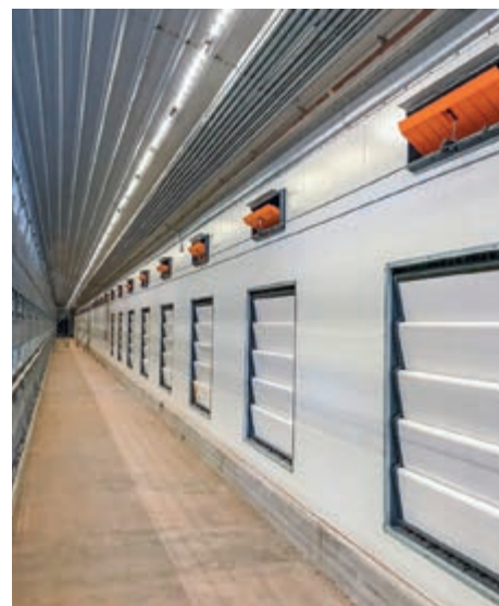
Kurnik wolierowy z wentylacją Combi-Tunnel, w którym zastosowano wloty ściennie CL 1911 F i żaluzje MVT
