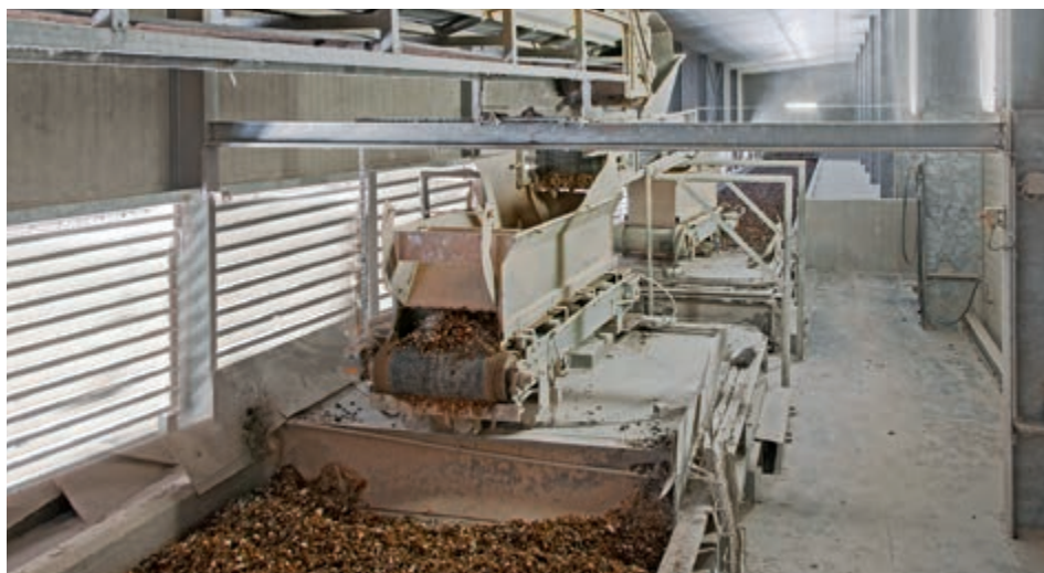
Stazione di caricamento: due sistemi OptiPlate, installati uno di fronte all'altro riforniti dallo stesso nastro trasportatore
