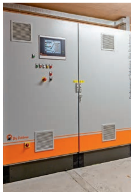
Cabina di controllo con modulo Amacs »Tunnel di essiccazione della pollina OptiSec «
