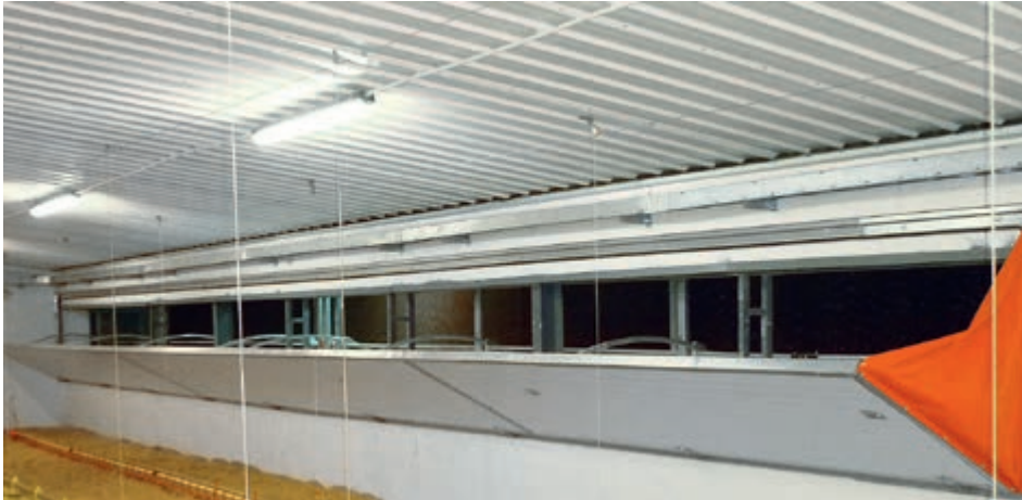
Bâtiment de poulets de chair avec volet tunnel ouvrant vers l'intérieur du bâtiment
