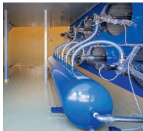
Nettoyage des filtres à l'air comprimé
