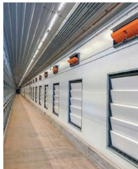
Nave de aviarios con ventilación Combi-Túnel y utilización de entradas de aire de pared CL 1911 F y persianas MVT
