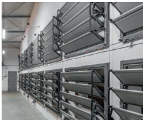
MultiVent 17 M in der Giebelwand für Tunnelventilation
