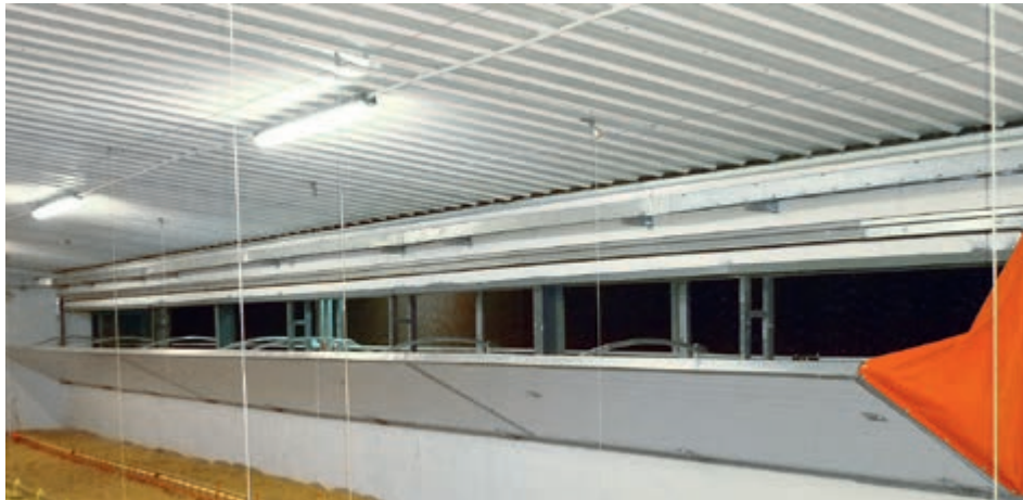
Broilerstall mit Tunnelklappe in den Stall öffnend
