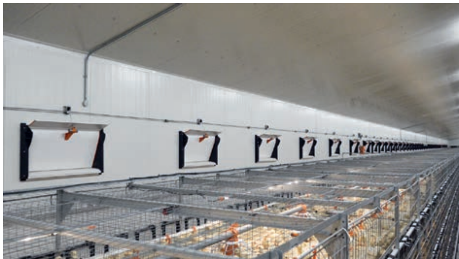
Клетъчно отглеждане на бройлери в AviMax-транзит: въздухът навлиза през клапите с фланец CL Flex
