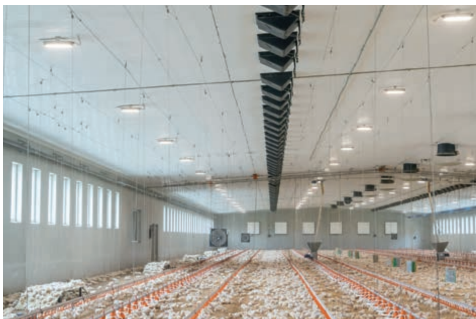
Използване на клапа за таван CL 1540, монтирана на междинния таван в сграда за бройлери
