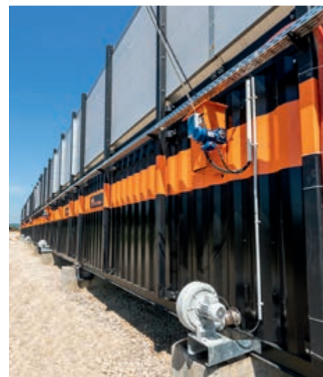
Компресор подає свіже повітря на ділянку із сировиною, що компостується
