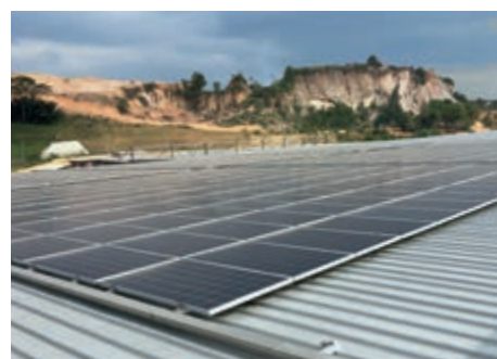
Moc urządzenia – 445 kWp
