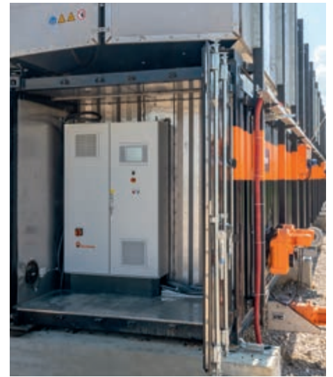
Szafa sterująca do w pełni automatycznego sterowania
