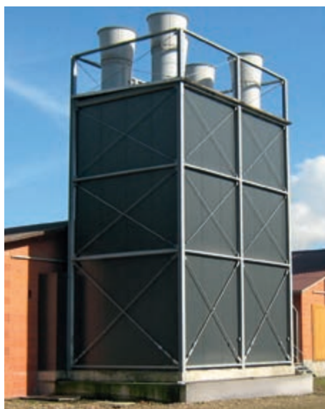
Torre di estrazione dell'aria
