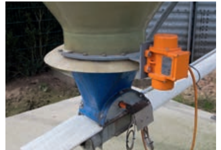
Silo avec vibreur électrique
