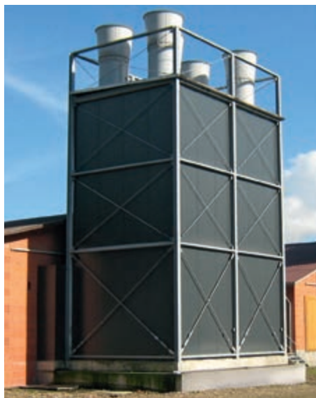
Torre de ventilación
