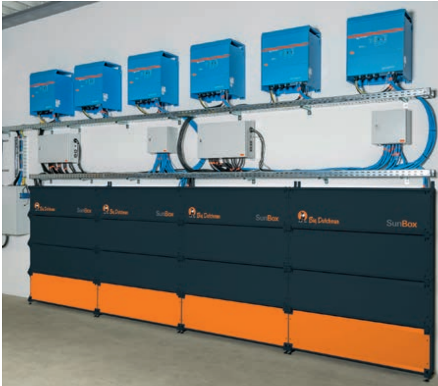
16 módulos con una capacidad total de 224 kWh
