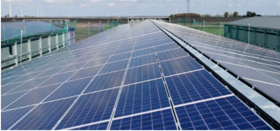
Rendimiento de la instalación: 749 kWp
