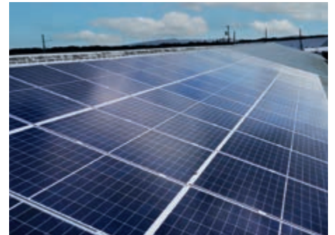
Rendimiento de la instalación: 30 kWp
