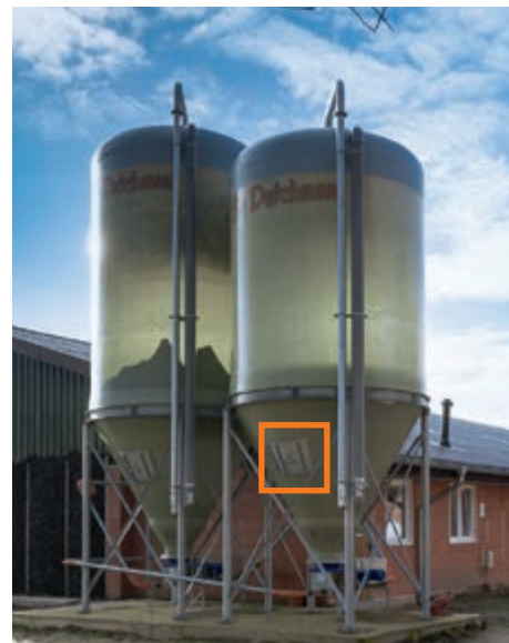
Silos de PRFV con cadena transportadora DR 1500
