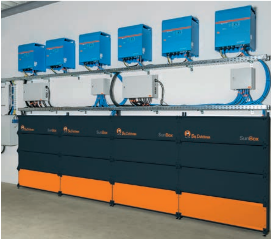
16 Module mit einer Gesamtkapazität von 224 kWh
