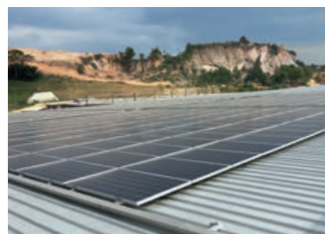
Мощност на инсталацията – 445 kWp
