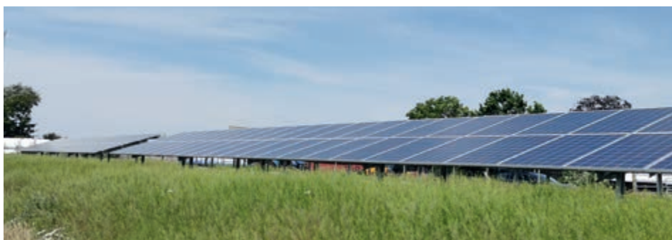
Мощност на инсталацията – 49 kWp
