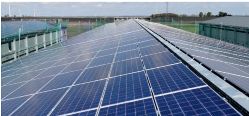
Мощност на инсталацията – 749 kWp
