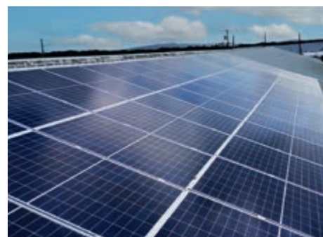
Мощност на инсталацията – 30 kWp
