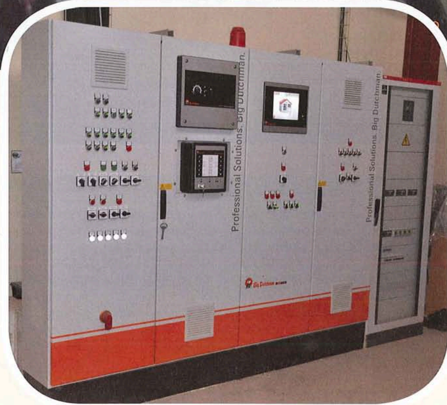
El armario con el ordenador y los equipos de control de la nave.
